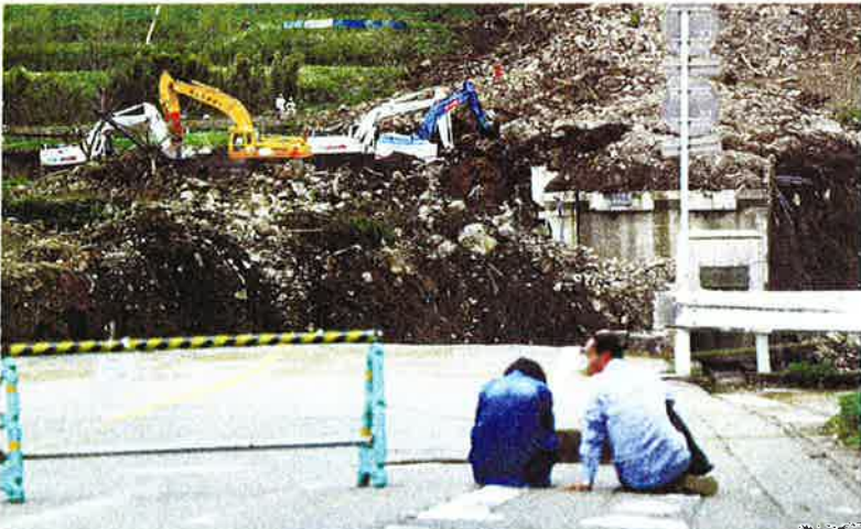
土砂崩れに巻き込まれたとみられる大学生、大和晃さんの家族が、阿蘇大橋の崩落現場で捜索を見つめる。父(右)が「とにかく捜し続けてほしい。家族の元に帰って来て」とつぶやいた。2016年4月16日 Photo by Jiji Press Photo
