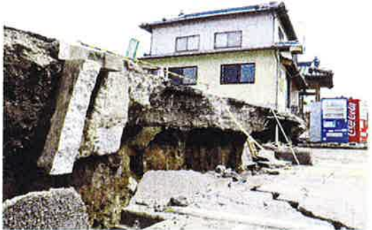
16日未明の地震で陥没した道路。道路とともに自宅が陥没した高橋広作さんは「どーンという音がして家ごと1.5メートルほど落ちた」と話した。熊本県阿蘇市狩尾。Photo by Yomiuri SIMBUN via Afla
