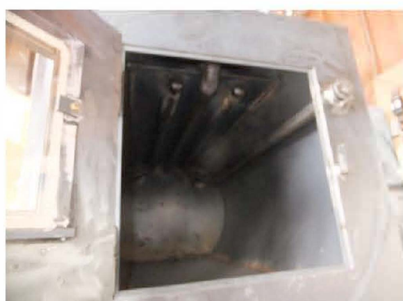
内部 上部に見えるのが2次燃焼パイプ2本 中央が3次燃焼パイプ
