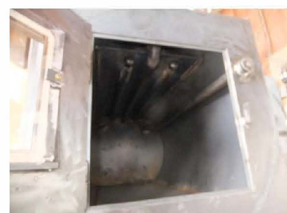
内部 上部に見えるのが2次燃烧パイプ2本 中央が3次燃烧パイプ
